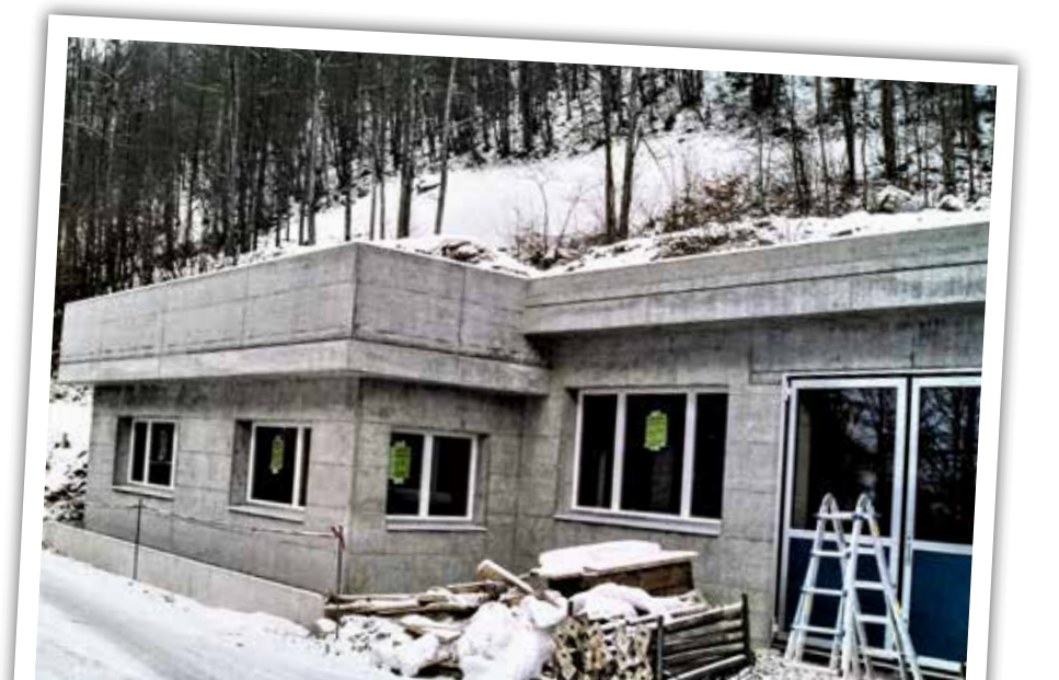
Dank Mehrzweckraum Gubeli erhält die Jugendgruppe ein Lokal für ihre Treffen. (Heimarbeit-Werkstatt, hier 1997 im Rohbau).
